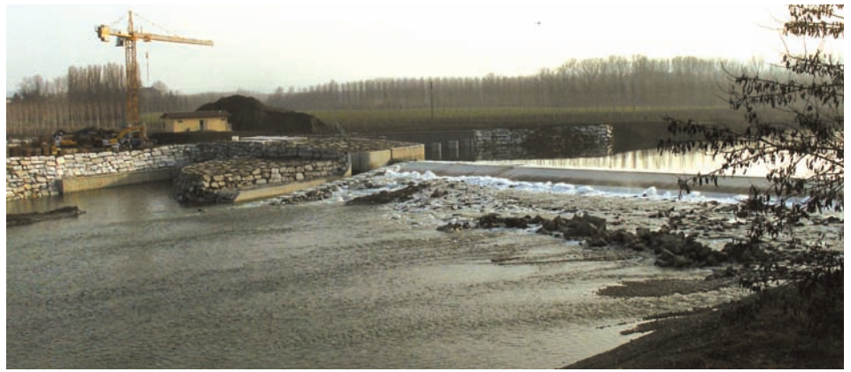
Fig. 12 – Chiusa di sbarramento attuale con la nuova centralina per la produzione di energia elettrica
